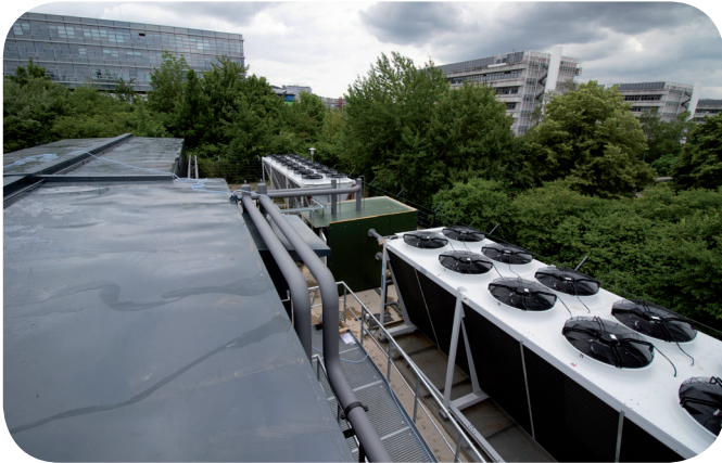
4_Freiluftkühlung am MDC
